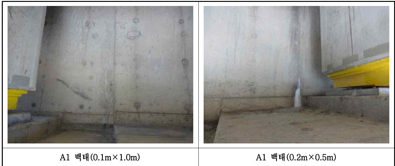
【사진 2.3.32】 교대 손상현황
