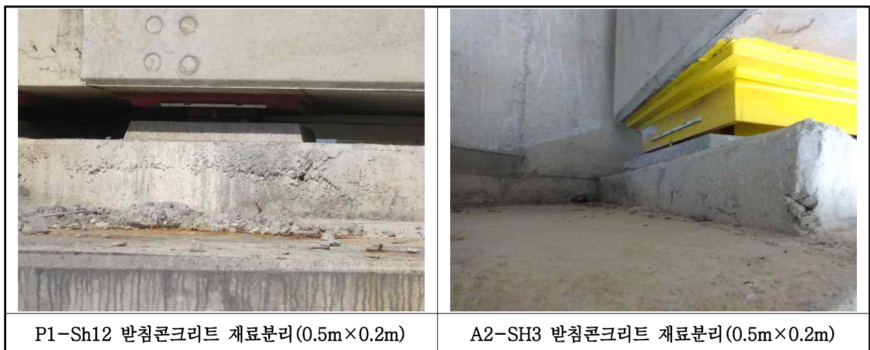
【사진 2.3.36】교량받침 손상현황
