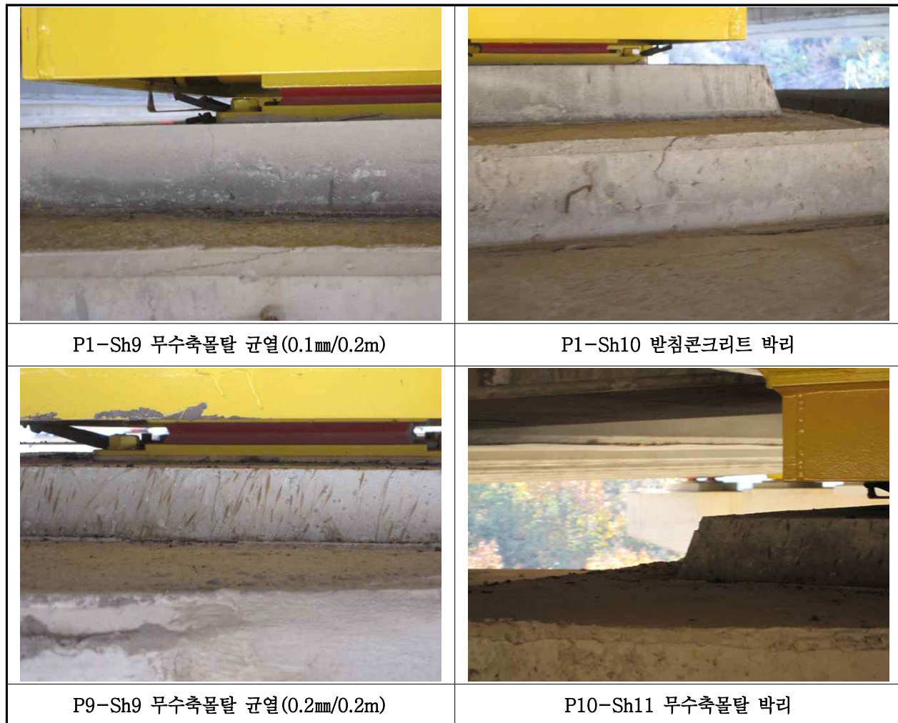
【사진 2.3.13】 교량반침 손상현황
