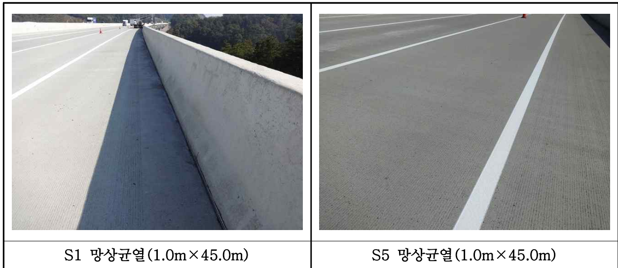
【사진 2.3.43】 교면포장 손상현황
